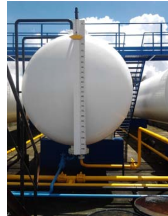
Figure 33 : Stockage d'huiles usagées (colonne de décantation)
