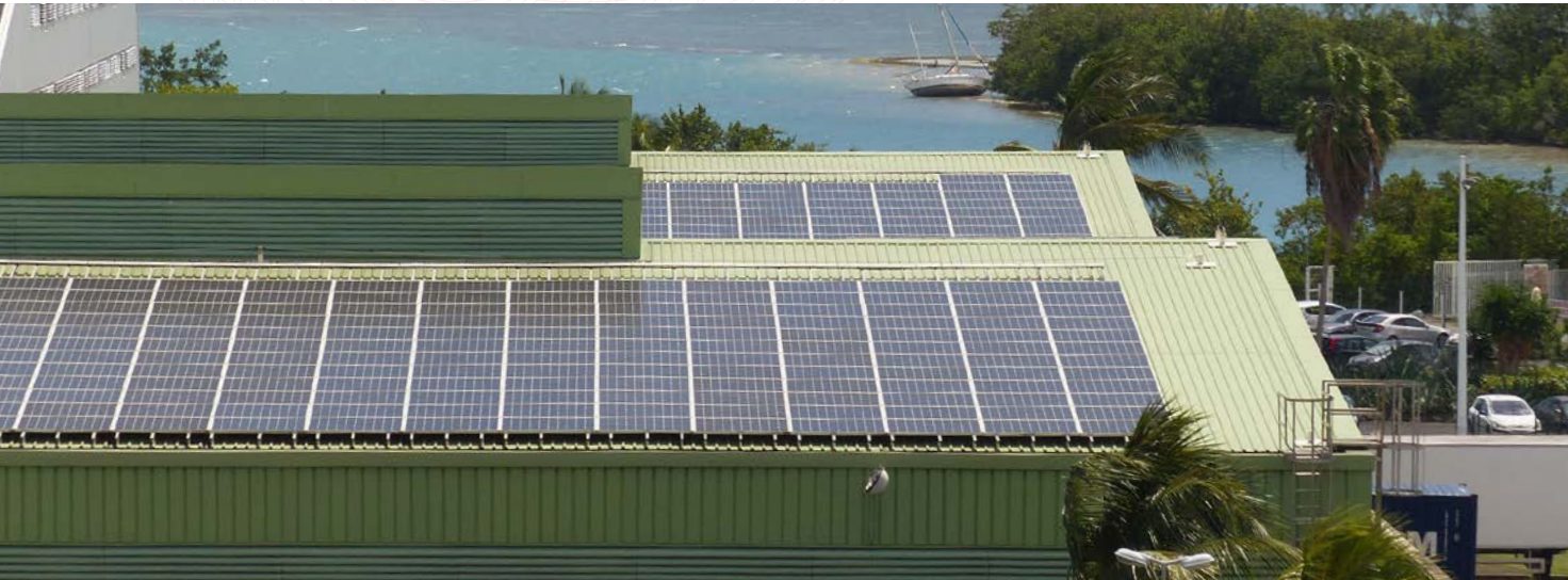
Centrale photovoltaïque sur toiture
